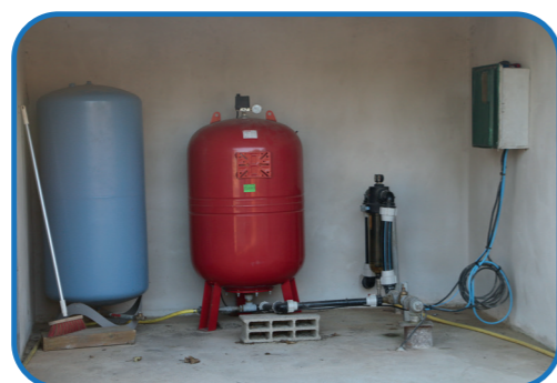
La pompe du forage remonte l'eau souterraine à la surface. L'eau est fraîche et claire.
