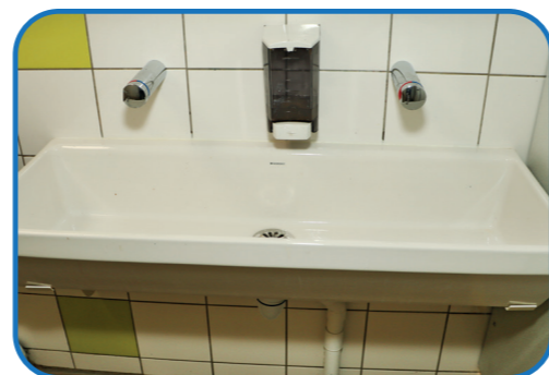
Les robinets distribuent l'eau potable.
